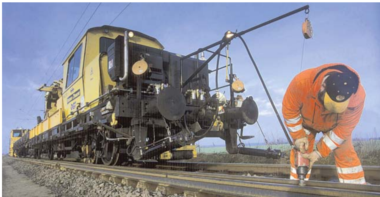
Wenn die Bahn wie hier auf einer Strecke in Ostdeutschland Gleisanlagen erneuert, gibt's kein Durchkommen mehr. Auf der Gäubahn stehen demnächst auch solche Arbeiten an. Die Strecke Singen-Stuttgart wird deswegen auf einem Abschnitt längere Zeit komplett gesperrt. Reisende müssen mit längeren Fahrtzeiten rechnen. BILD: ARCHIV DPA
