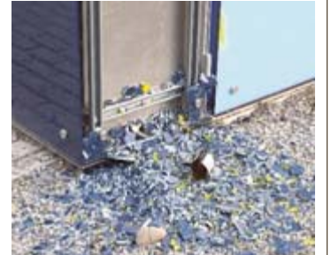
Zerstörte Glasverkleidung am WC-Häuschen im Herosépark. LANGE
